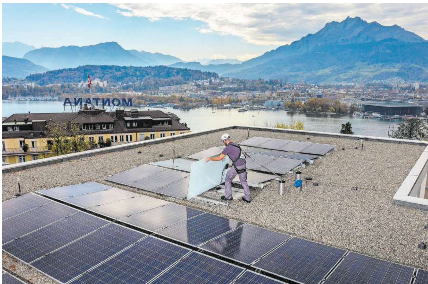
CKW-Solaranlage beim Betagtenzentrum Viva Luzern Dreilinden.
